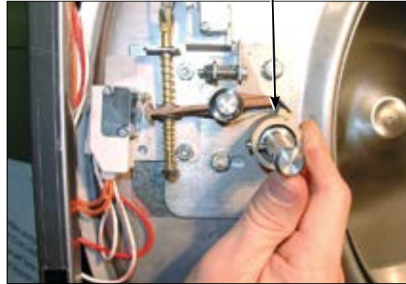
Door cam check position
